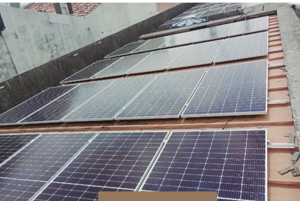
Instalação de sistema fotovoltaico no prédio da Divisão de Manutenção, em Belém
